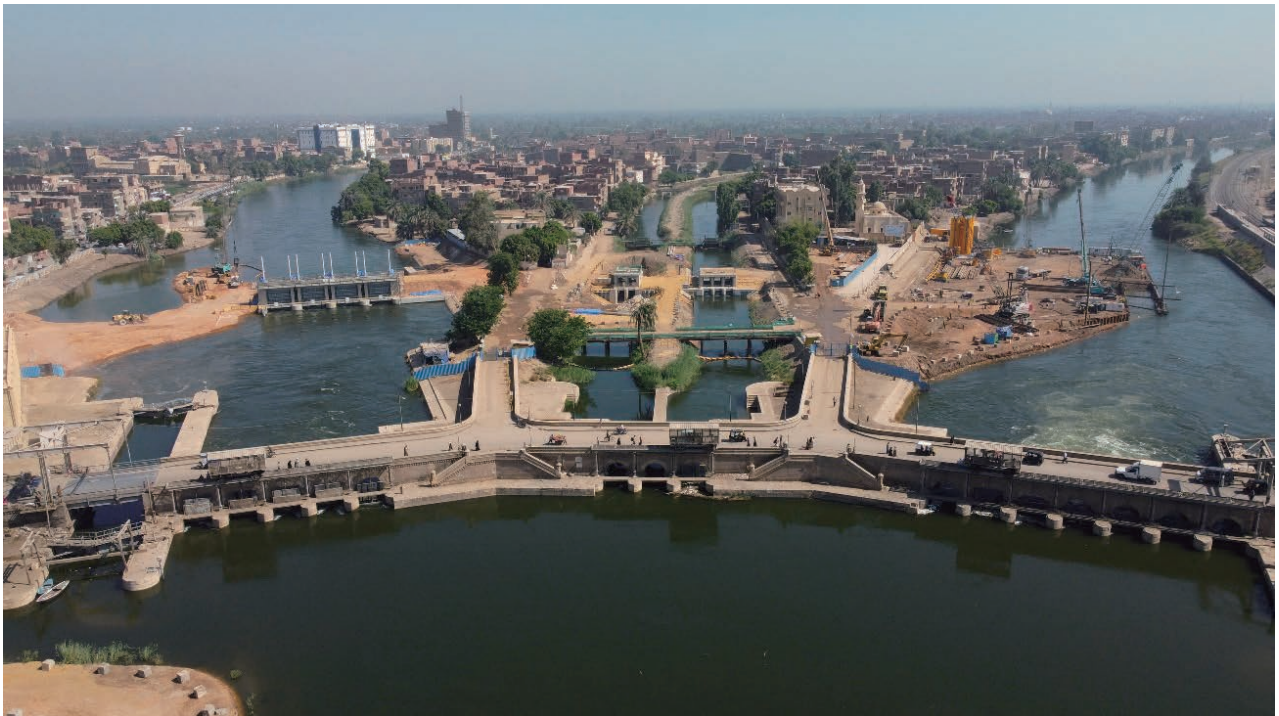
「新ダイルート堰群建設事業」工事現場の様子（2024年6月撮影、大日本土木株式会社提供）
